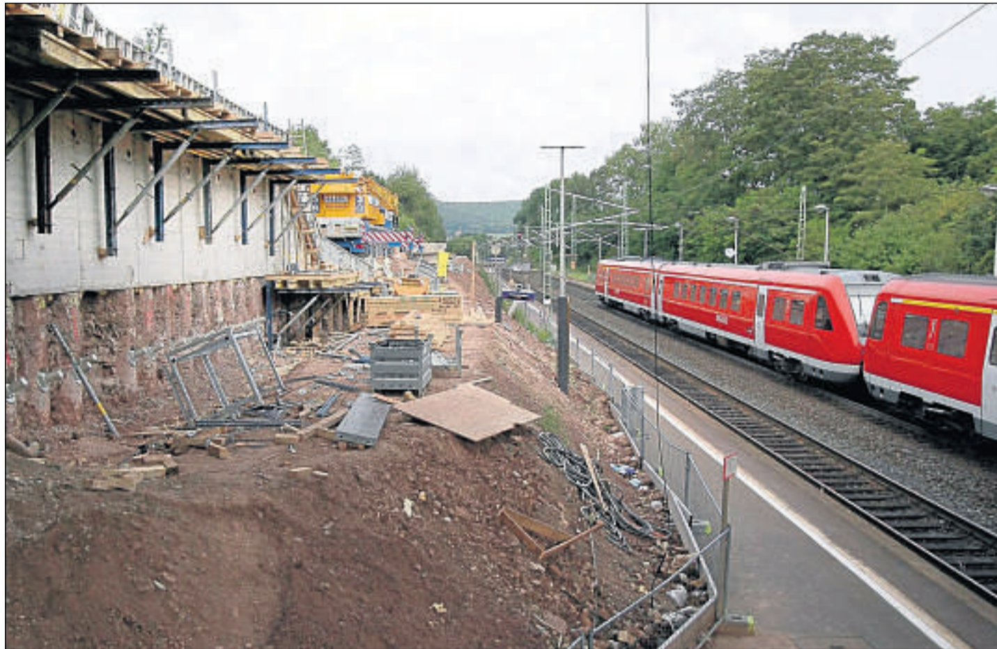
Betonmauer: Links im Bild ist das Betonfundament für die provisorische Stahlbrücke zu sehen, die den Zugang zum Bahnsteig in Richte-Hofgeismar ermöglichen soll, während die alte Steinbrücke abgerissen und durch einen Neubau ersetzt wird. Fotos: Wewetzer
