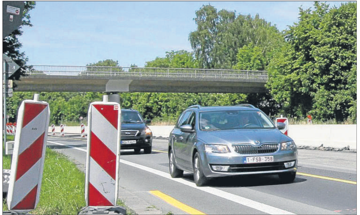
Unübersichtlich: Schon mehrere Unfälle gab es im Baustellenbereich der B 7/83, die wegen Fahrbahnarbeiten seit Juni nur einspurig geführt wird. Denn die Warnbaken, die zur Abgrenzung dienen, erschweren den Autofahrern die Sicht beim Ab- und Auffahren - wie hier an der Anschlussstelle Vellmar-Stadtmitte.
