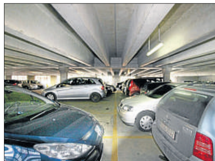
Vor dem Abriss? Auch Lösungen für das marode Parkdeck wurden im Masterplan erarbeitet.
