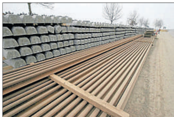
Warten auf den Einbau: Gleise und Schwellen liegen an der Wendeschleife Kollostraße schon bereit.
