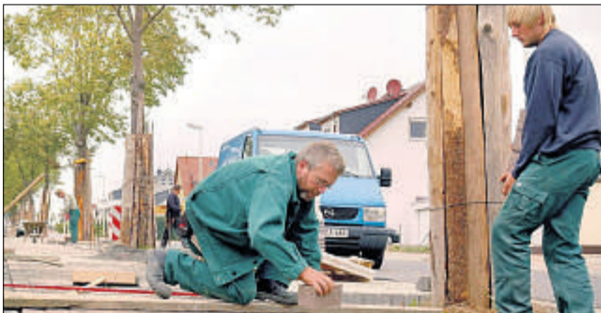
Neue Wege: Michael Andreas (links) und Felix Drescher von der Firma Landschaftsbau Mühlhausen pflastern entlang der Hans-Neusel-Straße. Foto: Brandau
