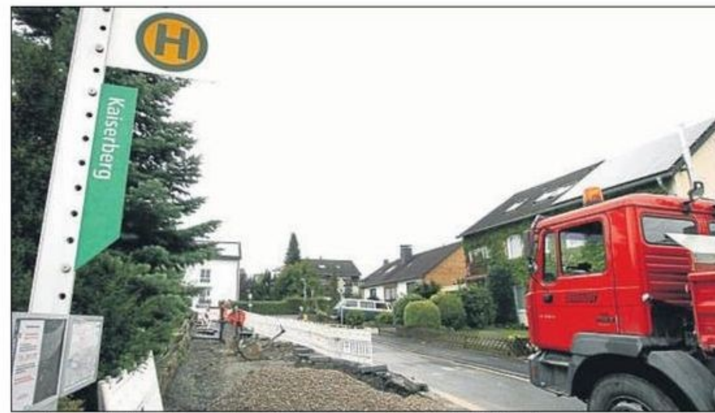
Umbau Bushaltestellen: Schon Ende 2012 wurde mit der behindertengerechten Umrüstung begonnen, in diesem Jahr geht es weiter.
