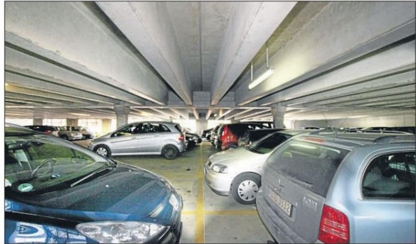
Besonders im Weihnachtsgeschäft gefragt: Das Vellmarer Parkdeck am Rathaus. Trotz Schäden kann es bis zur nächsten Untersuchung in etwa sechs Monaten weiter genutzt werden. Archivfoto: Wewetzer
