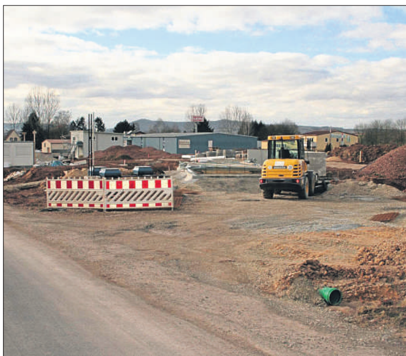
Noch eine Baustelle: In einigen Wochen sollen auf der Fläche an der Kämperbrücke Abstellplatz und Tankstelle des Reisedienstes stehen. Foto: Rogge-Richter
